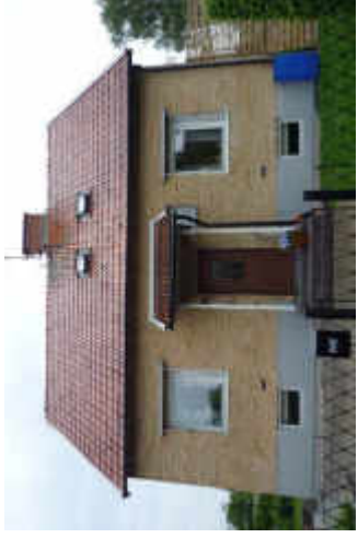
Kv. Munin 2, Lunavägen 6. Takfästningen på bilden kallas för "solarfläcka" och går igen på husets arkitektur.
